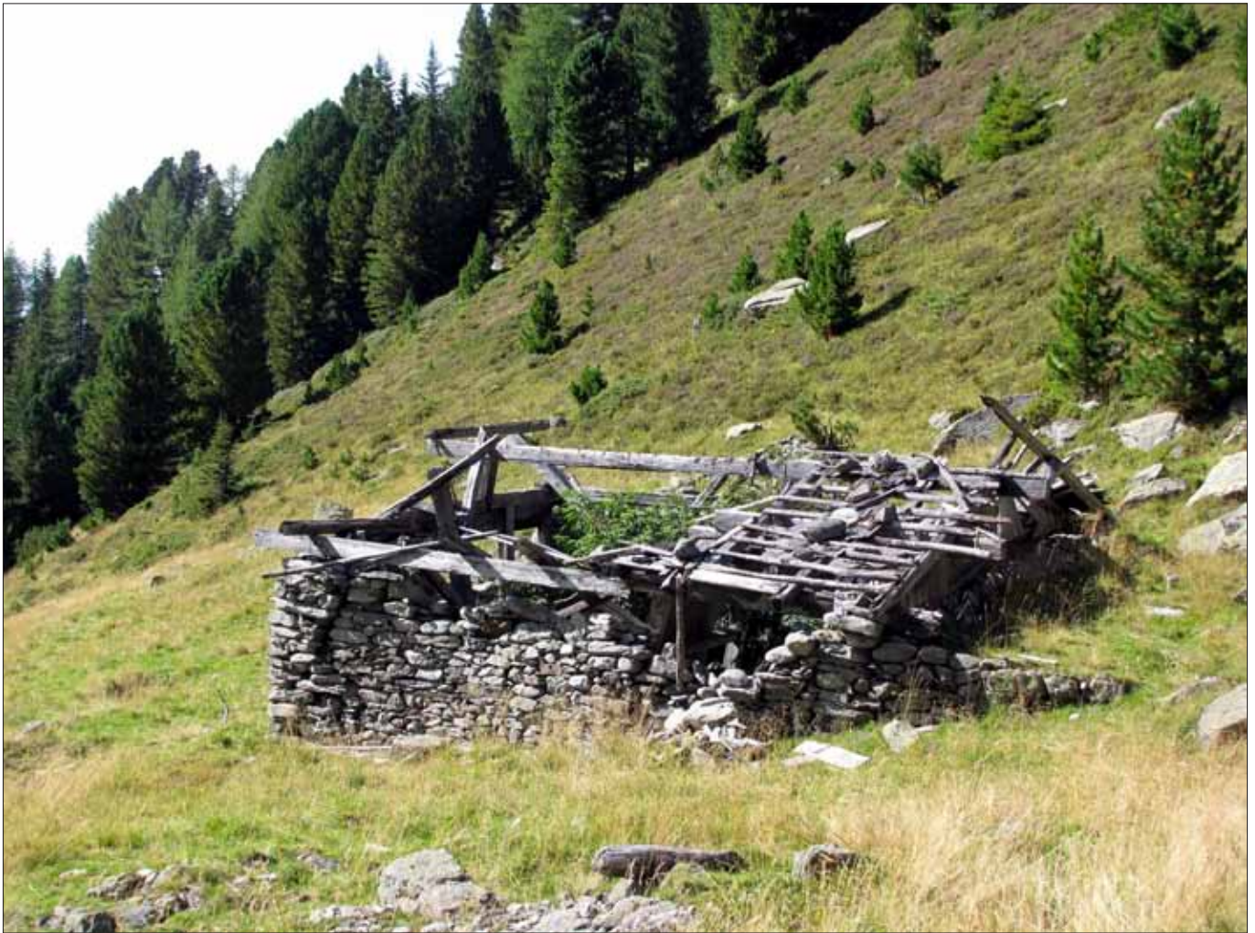
Abb. 2: Schöntalalm 1.942 m, VB Schwaz, KG Gerlos, Verfallende zweiteilige Almhütte in Mischbauweise mit einer hölzernen Trennwand zwischen den zwei Räumen. Das Dach ist größtenteils eingestürzt. Innen macht sich Bewuchs breit. Innenmaße 7 x 6 m, Innenmaße rückwärtiger Teil 6 x 3 m, Mauerhöhe Giebel 2,2 m, Mauerstärke 0,7 m
